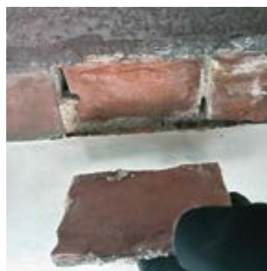
Øverst: Det var lagt maskinpapir på muren og malt med en tett maling. Dermed slipper ikke fuktigheten som kommer gjennom muren ut. Skadene er store.
